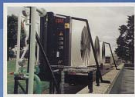
Kühlung der Aufladegebläselager EUROPA 2 vertikale Aufstellung
