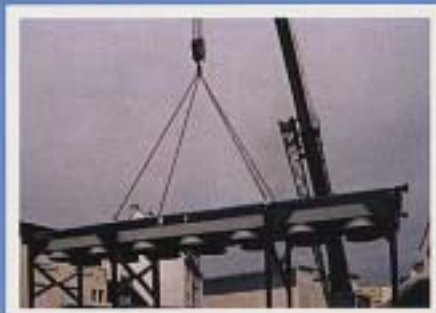
BHKW im Krankenhaus von Lorient Luftkühler mit erhöhten Standfüßen
