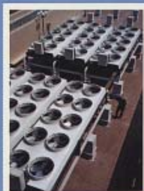
Kühlung von Transformatoren Drehzahlregelung über Frequenzumrichter
