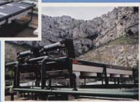
Kraft-Wärme-Kopplung Kläranlage in Marseille EUROPA 2 mit Ausdehnungsgefäßen
